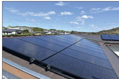
Die Anlage kann mit ihren 142 Solarmodulen jährlich bis zu 60.000 Kilowattstunden Strom erzeugen.
